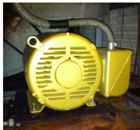
New variable speed fan
